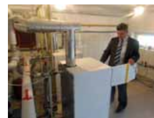
Wszędzie zainstalowano jeden typ pieców
