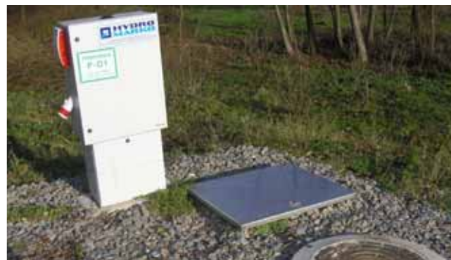
Przepompownia w przysiółku Dębno-Dębczak to tylko fragment największej na terenie gminy ekologicznej inwestycji, dzięki której podniósł się poziom życia mieszkańców
